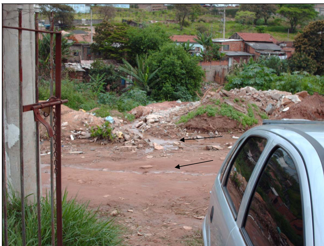
Figura 102 – esgoto a céu aberto em direção ao riacho
