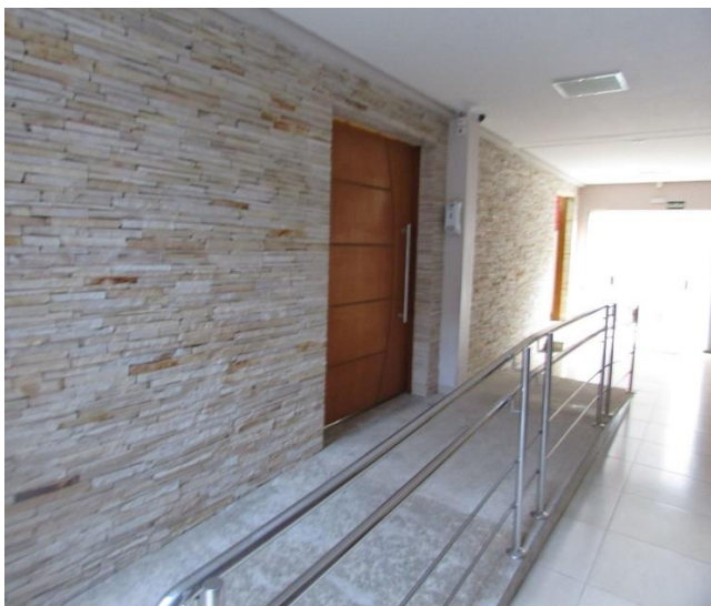
Figura 25: Fotografia da Igreja Metodista de Santo André, SP. Detalhe: Acesso à nave da igreja I [com rampa]
